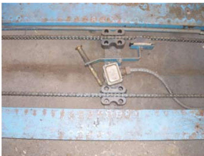
3. kép: csápos emelő túldoldali emelőorsó hajtólánca a lazulást jelző végálláskapcsolóval
