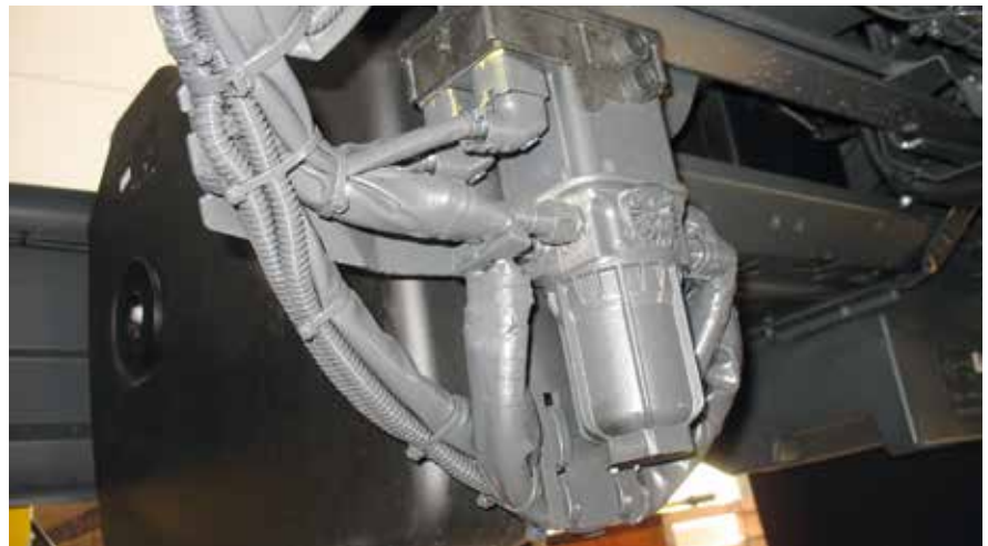
Az AdBlue előkészítő (szűrő) és nyomásfokozó, mely a motor leállítása után, a fagyveszély miatt, az AdBlue visszaszívást is elvégzi.
